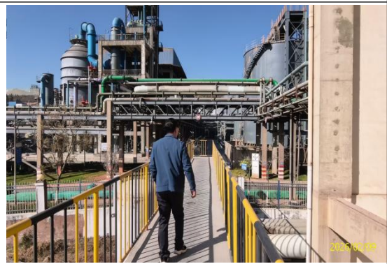
原料磷石膏输送管道
