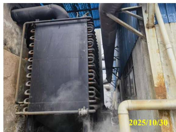
原有锅炉节能器
