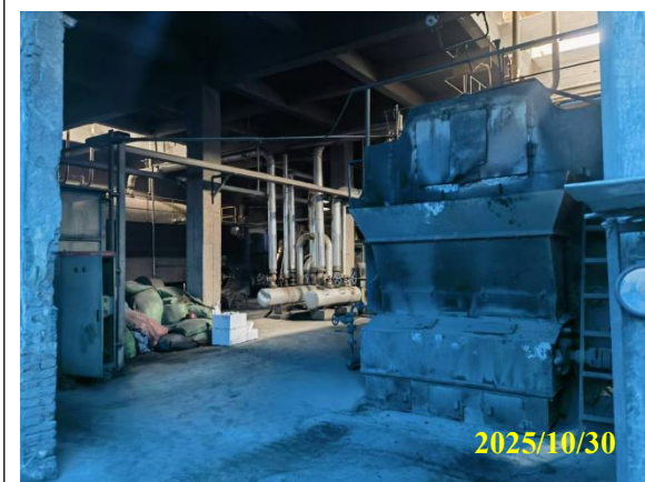
拟改造的燃煤锅炉
