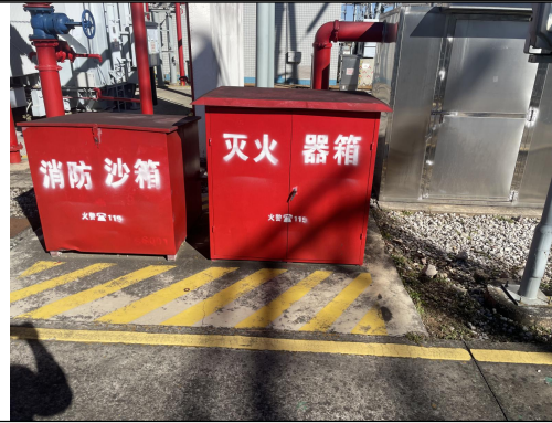
站内消防设施
