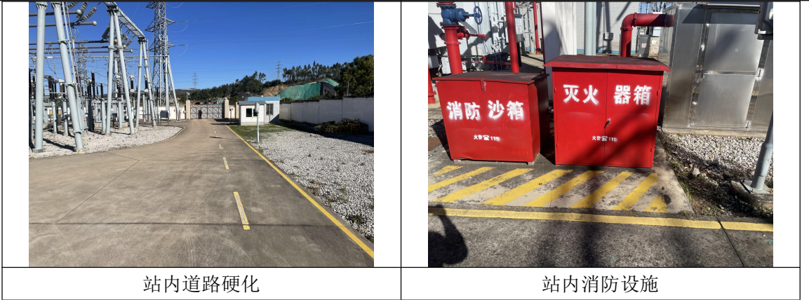
图 3 220kV 樟木箐变电站部分环保设施实景照片
