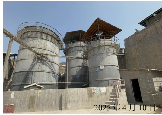
硫酸、磷酸储罐
