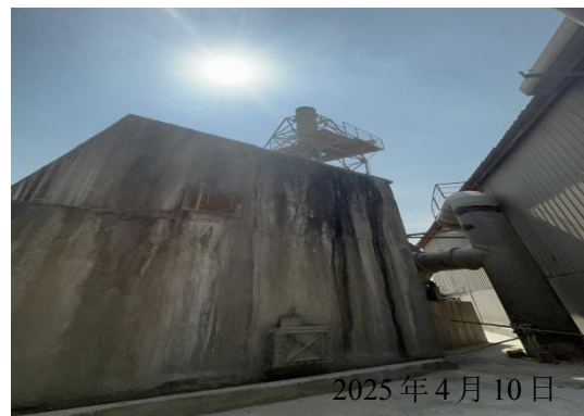
湿法脱硫设施及排气筒 DA004
