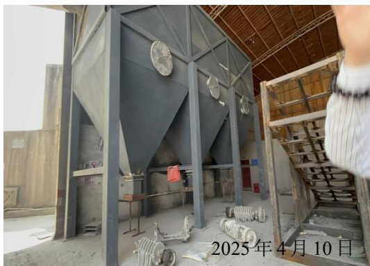
重力沉降设施
