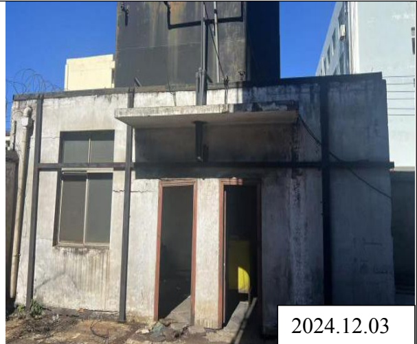
依托中水处理站
