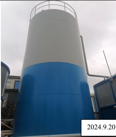
UASB 污水处理设备
