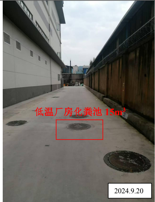
低温厂房化粪池
