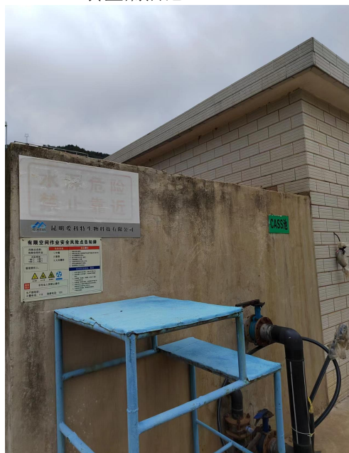
CASS 工艺处理池
